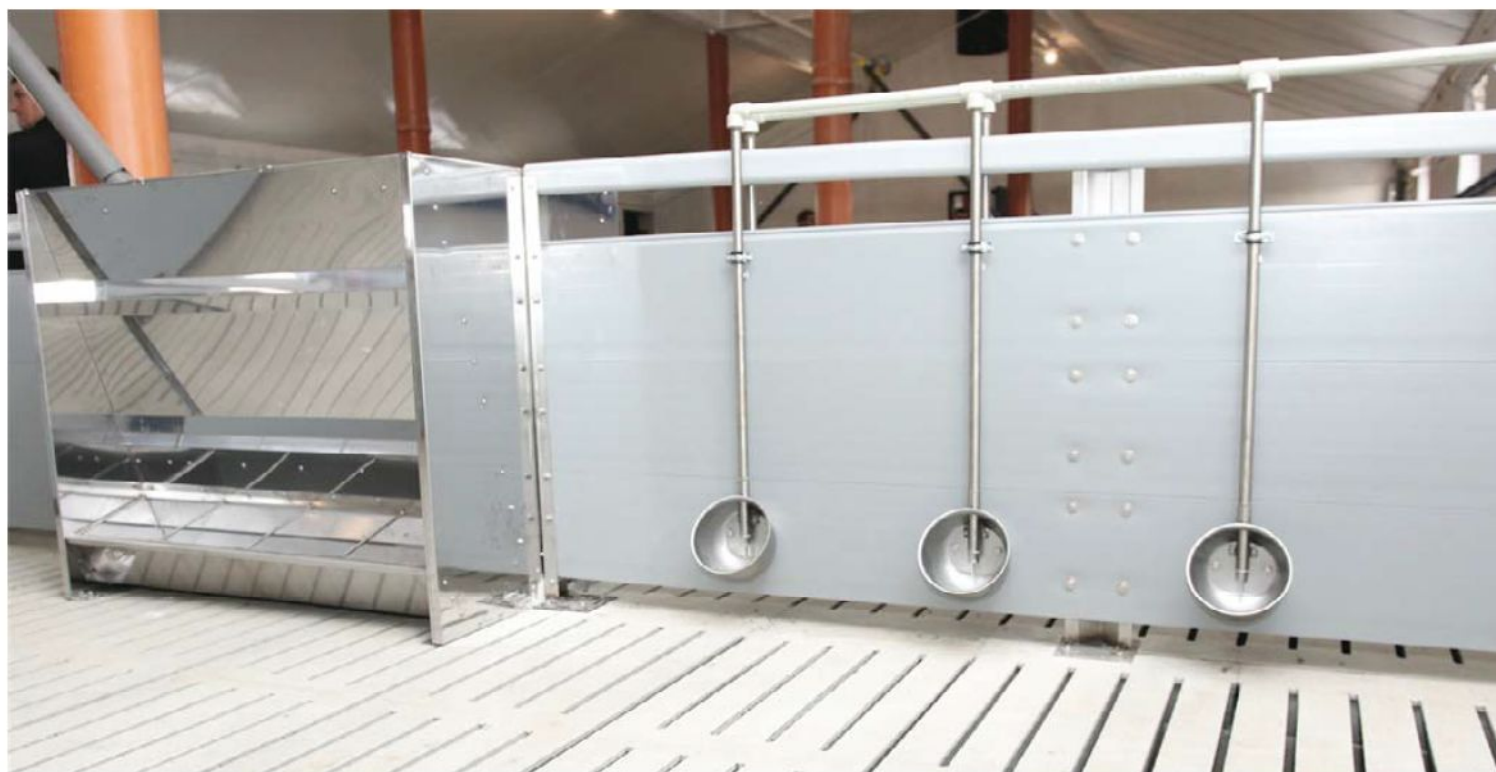
Posadzki w kojach pokryte atestowanymi szczelinowymi rusztami betonowymi o długości 2,7m, spełniające wszelkie wymogi weterynaryjne. Powierzchnia szczelin wynosi ok. 15 proc. ogólnej powierzchni podłogi co zapewnia utrzymanie czystości Fot. Maciej Nowicki
